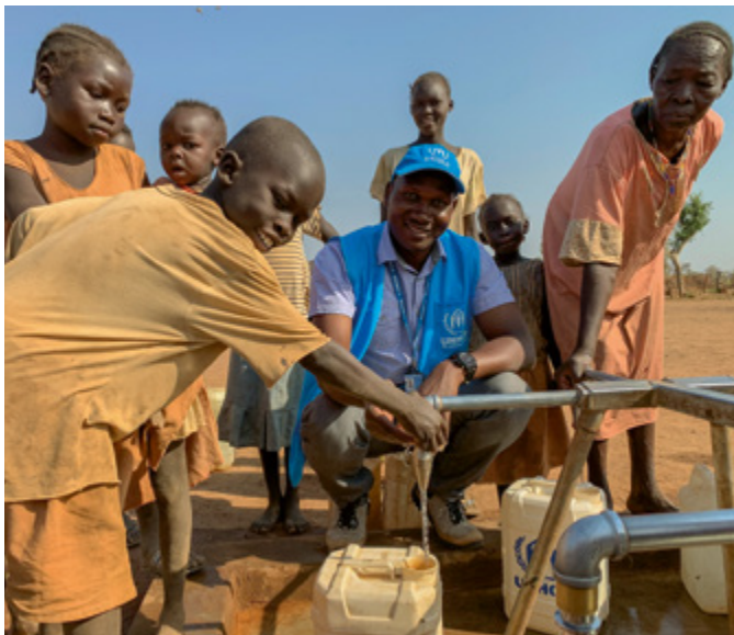
Jamjang, Südsudan: Patrick Okello und sein Team sorgen für sauberes Trinkwasser und bauen sanitäre Einrichtungen. © UNHCR/A.Corluka
